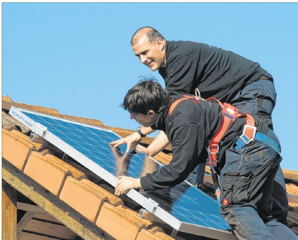
Auch über Photovoltaikanlagen wird während der Energietage informiert. BILD: SCHÖTT SOLAR
